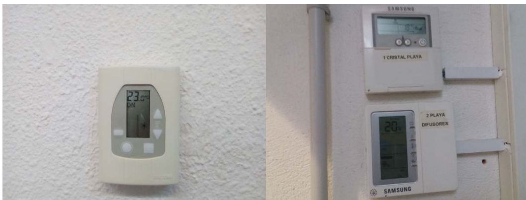
Imagen 21. Termostatos consigna zona urbanismo y zonas planta baja
