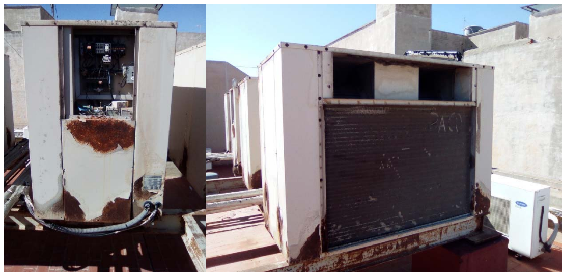
Imagen 28. Estado de conservación unidades exteriores equipos de climatización Hitecsa
