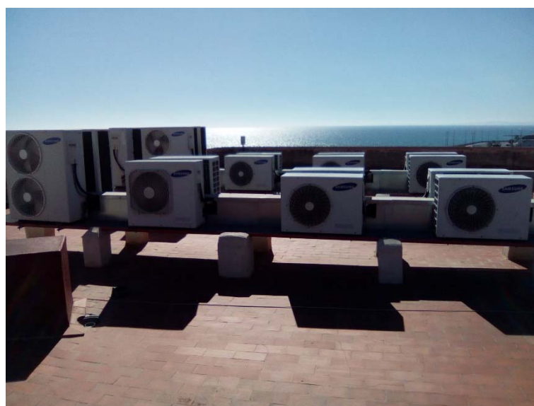
Imagen 8. Unidades exteriores de equipos de climatización de planta baja
