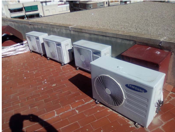
Imagen 9. Unidades exteriores de equipos de climatización tercera planta zona acristalada
