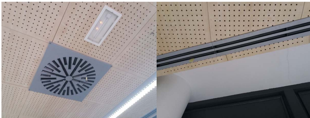
Imagen 10. Difusores de las unidades de conducto en planta baja
