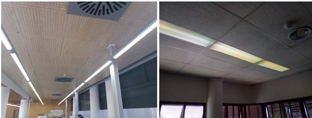
Imagen 7. Luminarias instaladas en el centro
