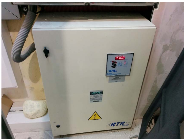
Imagen 23. Batería de condensadores automática en CGBT del edificio
