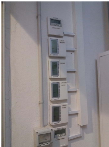
Imagen 11. Paneles de control remoto de las unidades de conducto de planta baja.
