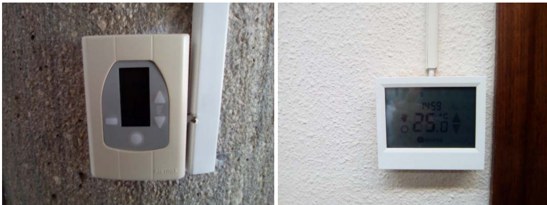
Imagen 16. Termostatos Airzone instalados en las dependencias
