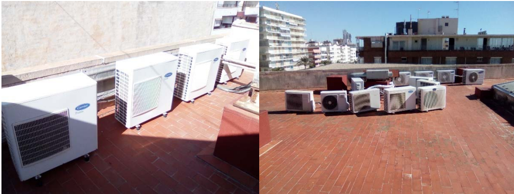
Imagen 12. Unidades exteriores de equipos de climatización tercera planta zona acristalada
