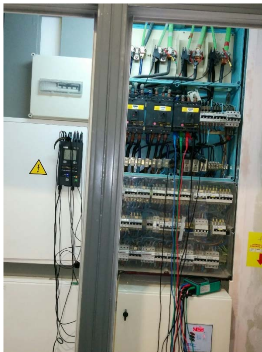
Imagen 20. Cuadro eléctrico general de baja tensión
